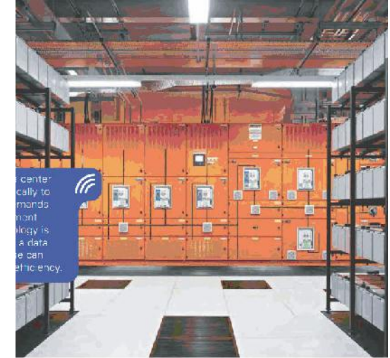
ACBs Terasaki protegiendo la carga de datos en Telehouse Docklands
